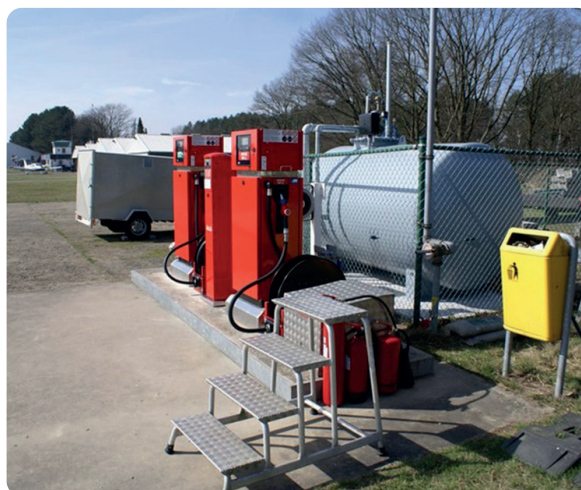
Gloednieuwe tankinstallatie met dubbele pomp.
