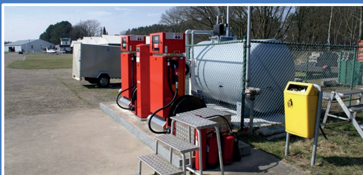
Gloednieuwe tankinstallatie met dubbele pomp.
